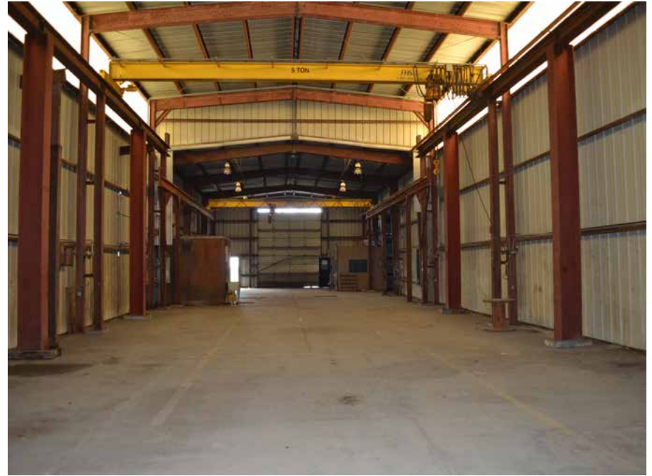
3 Ton and 5 Ton Bridge Cranes
