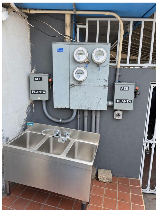
Contadores independientes e interruptores de transferencia para planta
