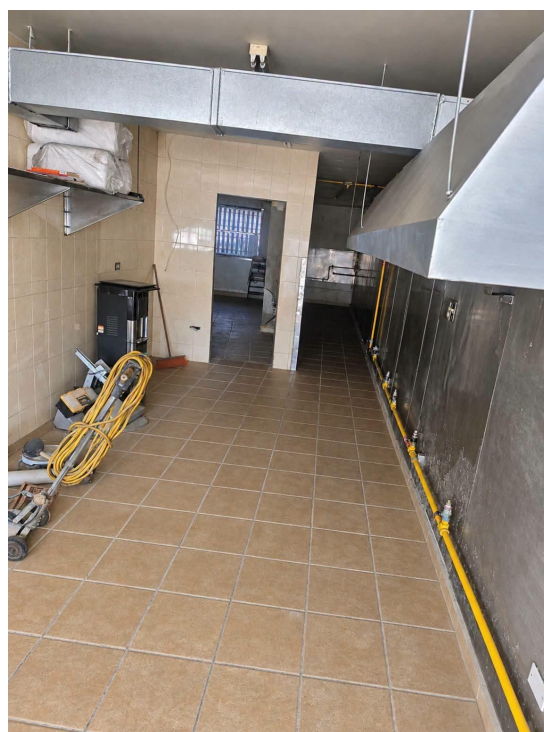
Área de cocina comercial con campana de extracción y línea de gas
